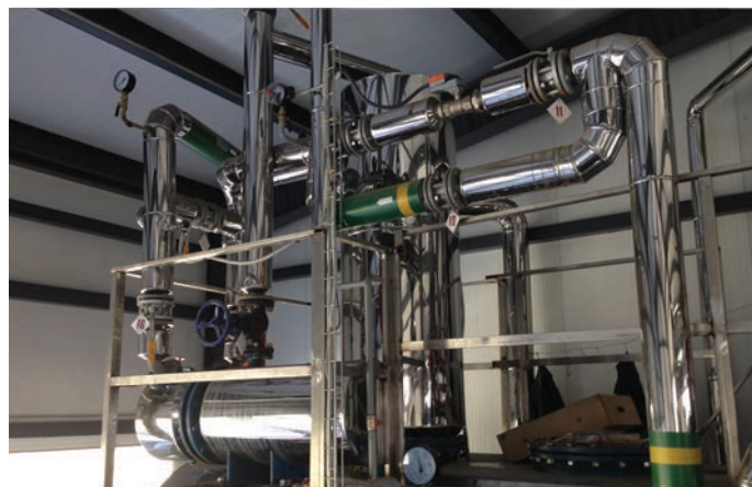
Деаераційна установка ДА-5/4 з щитом керування на контролері в паровій котельні (винзавод, Одеська обл.)
