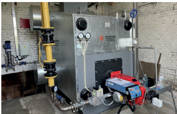
Паровий котел Е-1,0-0,9ГМ для роботи на природньому газі з встановленим пальниковим пристроєм Cibital Unigas (Італія) (винзавод "Коблево", Одеська обл.)
