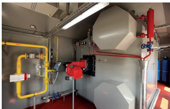
Паровий котел Е-2,5-1,4ГМ для роботи на природньому газі з встановленим пальниковим пристроєм Cibital Unigas (Італія) (завод з виробництва пінопласту, Дніпропетровська обл.)
